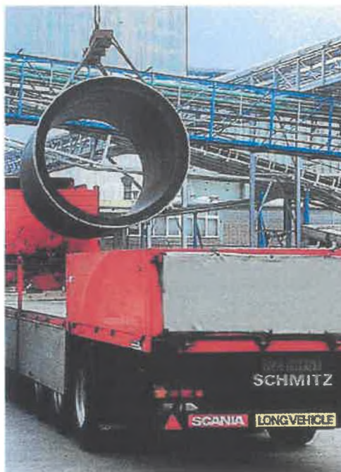
Колектор за отпадъчни води от полимербетон DN 2000 на промишлена платформа
